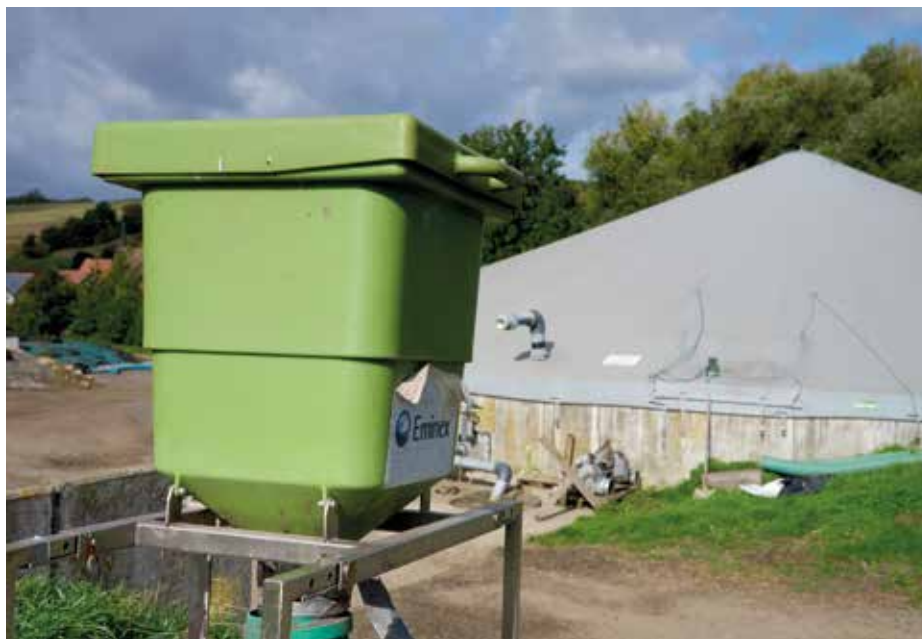
Mithilfe eines Dosierers wird ein Gülleadditiv in den Güllestrom zum Endlager eingefügt.
