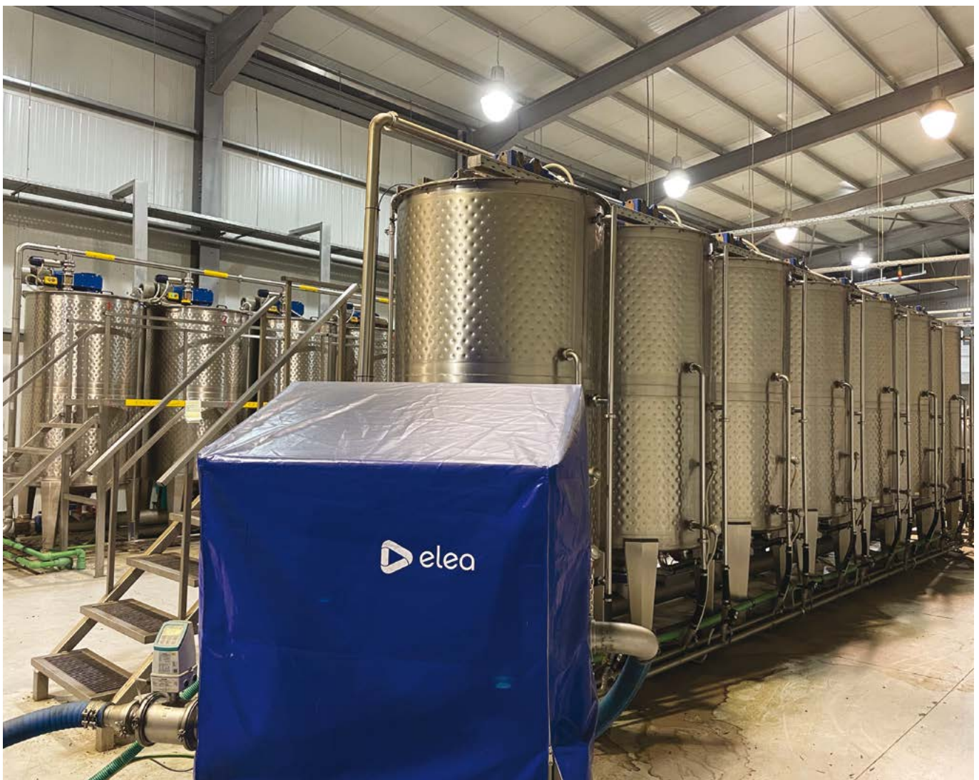
Abbildung 9: Rohrsystem in einer griechischen Olivenölmühle
