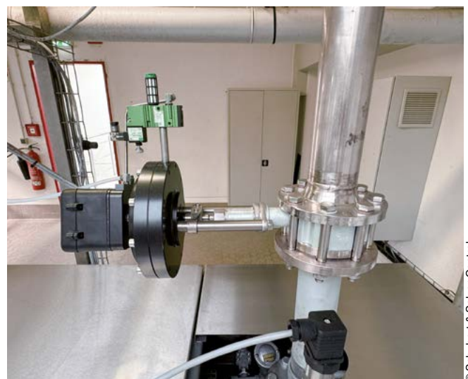
Gleitschieberventil an Energify
