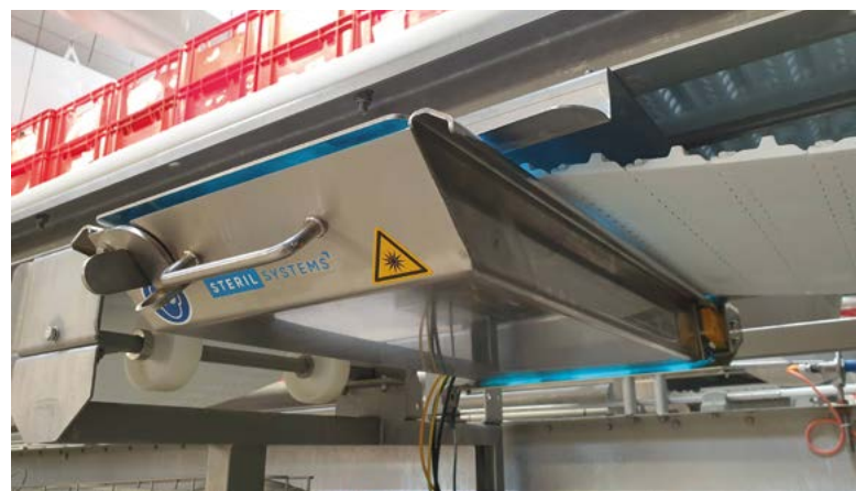
Die kontinuierliche Desinfektion der Förderbänder übernehmen in allen Produktions- und Verpackungslinien sowie den Abfüllanlagen Bandentkeimer vom Typ FPK.
