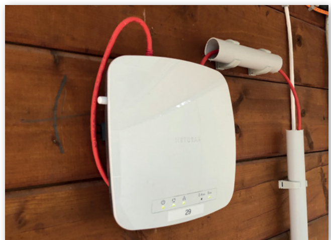
Abbildung 7: WLAN Access Point (Quelle: Feldmann)
